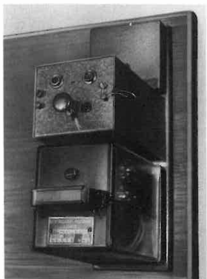
Foto 74 Zariadenie pre kontrolu činnosti izolovanej koľajnice
