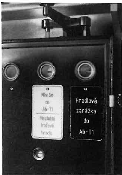
Foto 84 Hradlové závery stavadlového prístroja hradla
